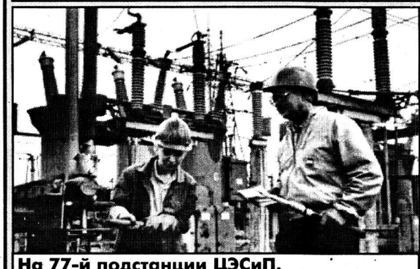
На 77-й подстанции ЦЭСиП.
